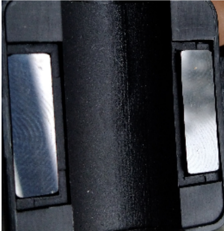
Рис. 4. На магнитопроводе видны отпечатки пальцев и пыль. Точность измерений будет низкой
